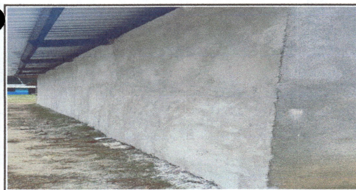
Foto 5: Evidencia de repello en paredes antes de colocar la pintura del modulo I
